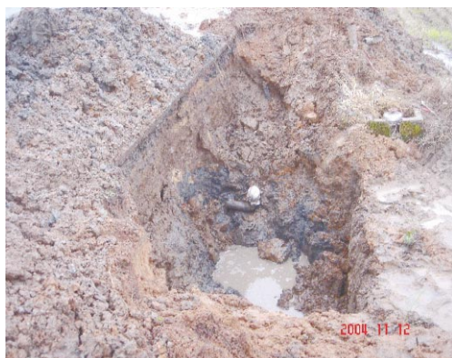
Fig.14 パイプラインの破損 Damage of pipeline
