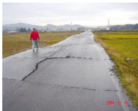
Fig.18 アスファルト舗装の亀裂・破損 Crack and damage of asphalt pavement
