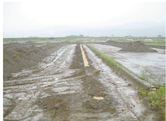
Fig.23 再整備が図られた本暗渠 (旧淡路町岩野, 2005.7.4撮影) Main drain maintained again
