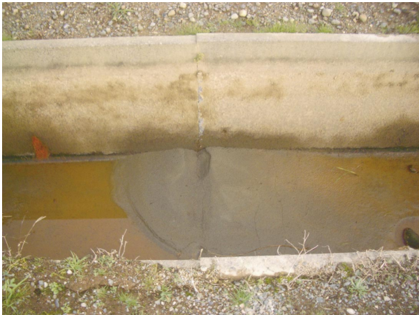
Fig.20 機場への導水路底板継目からの土砂噴出（04.10） Sand gushing from a joint of concrete canal connecting the pump station
