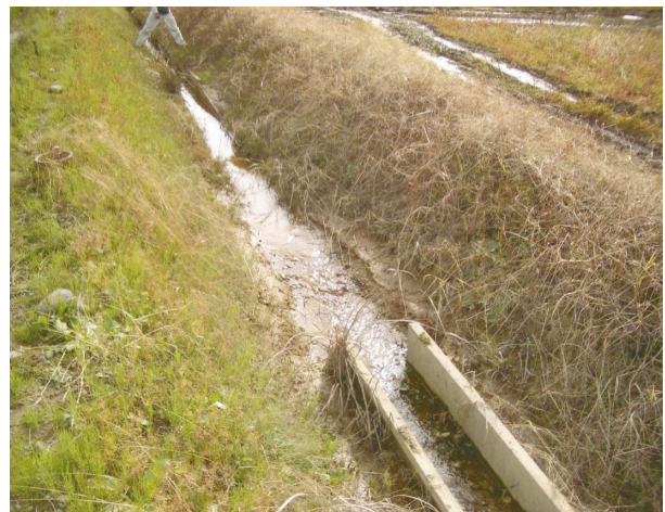
Fig.23 支線排水路（コンクリートフルーム）の沈下（04.10） Settlement of a tertiary drainage canal (concrete flume)
