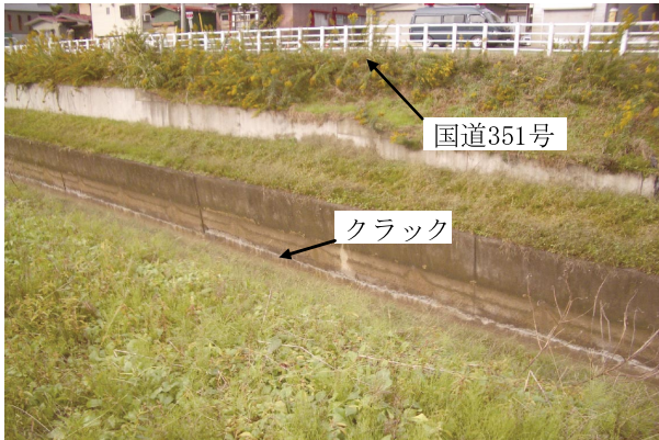
Fig.9 1号幹線用水路左岸側壁底部水平クラック（04.10） Horizontal cracking in left bank wall of No1 main canal
