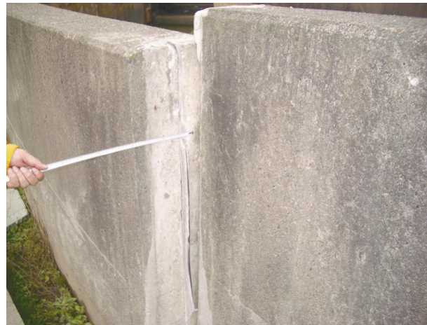
Fig.18 サイホン工上流継目の水平変位 (04.10) Horizontal displacing in the siphon inlet canal
