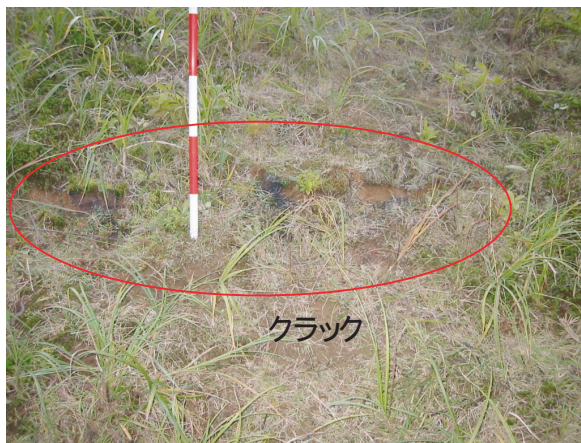
Photo 13 下流斜面に発生したクラック A crack on the down stream slope of Tsuboyama dam
