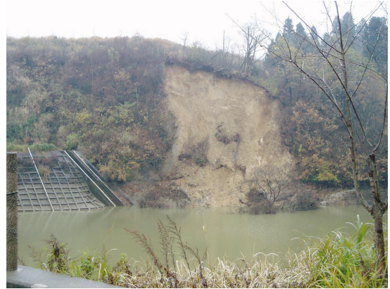
Photo 10 池敷地山斜面の崩壊
