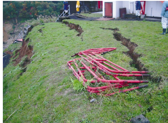
Photo 5 管理棟の盛土基盤上面に発生したクラック Cracks on the embankment foundation of the inspection building at Kawanishi dam
