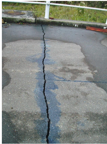
Photo 11 天端に発生した上下流方向のクラック A transverse crack on the crest at Gosyonae dam
