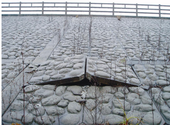
Photo 8 上流斜面の張ブロックのはらみ出し
