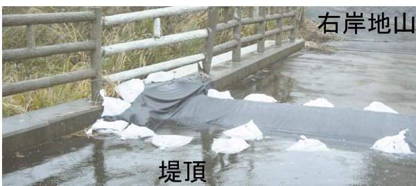
Photo 9 洪水吐取り付け部の段差とクラック
