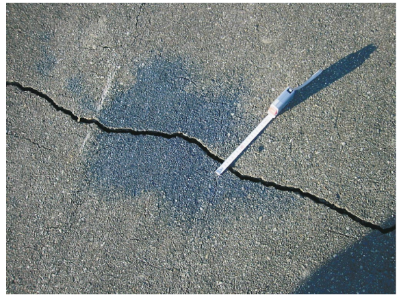
Photo 4 上下流方向に発生したクラック A transverse crack on the crest at Kawanishi dam
