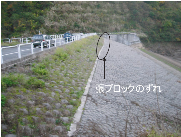
Photo 12 上流斜面における張ブロックのずれ Slip of concrete blocks on upstream slope at Tsuboyama dam
