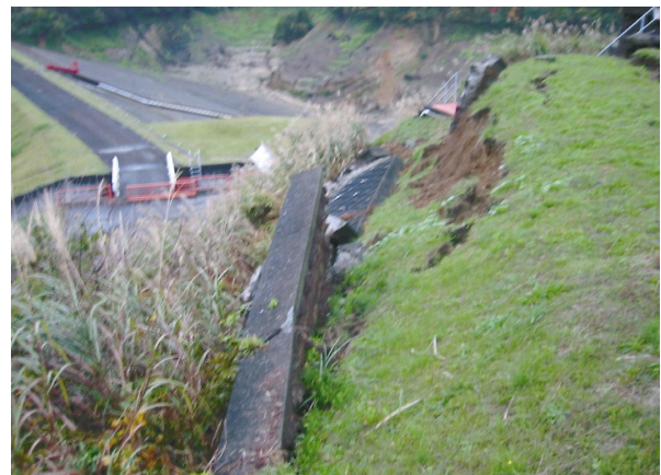
Photo 6 積みブロックの崩壊 Collapse of retaining wall at Kawanishi dam
