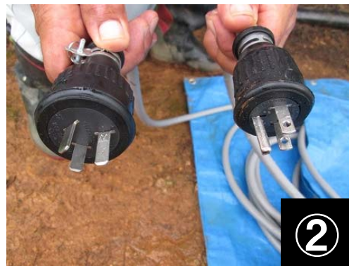
接続ケーブル
