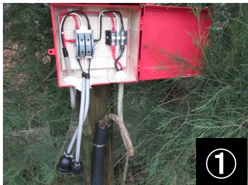
非常用電源ボックス
