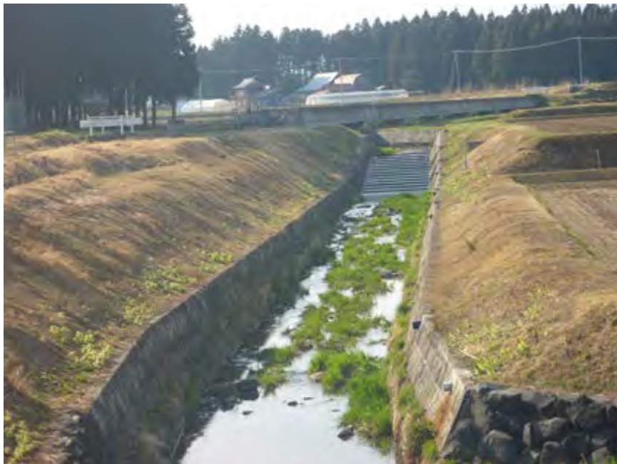
図 4-11 土砂の堆積により遷移が進んだ幹線排水路
