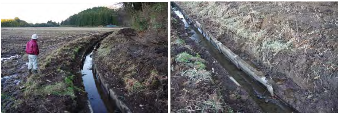
図 4-15 土壌流出をおこし水路法面が崩壊した二面張り柵渠水路
