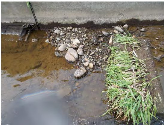
図 4-12 幹線水路内に設置された コンクリート水利工
