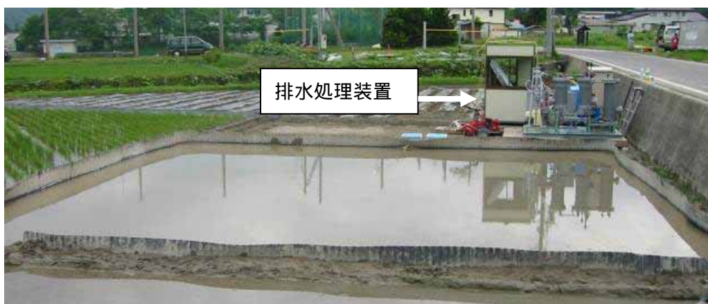
図3 洗浄圃場全景と排水処理装置
