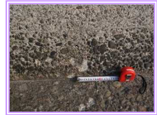
水路の摩耗状況
