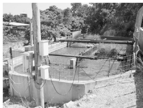
写真1 酸化溝型浄化槽
