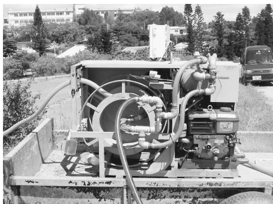
第 2 図 畜産処理水散布機 2 号機
