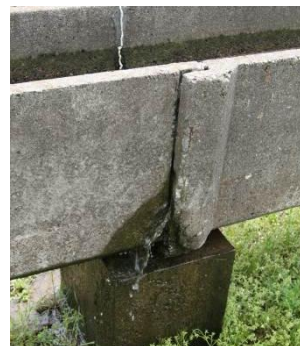
水路目地部からの漏水
