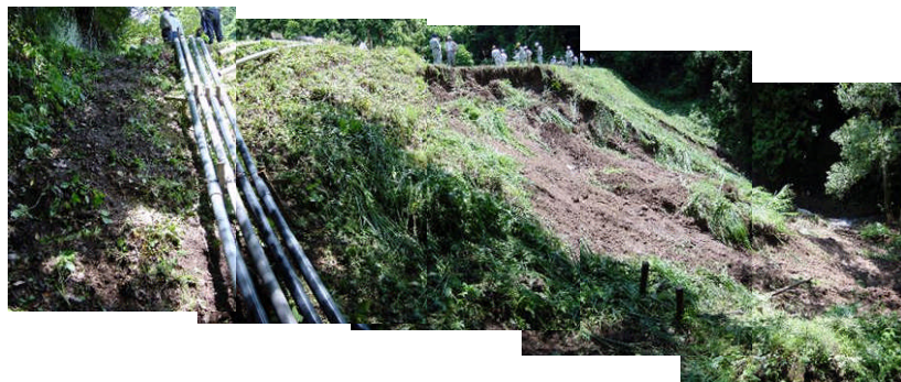
盛土斜面が崩壊したため池（左奥が貯水部）
