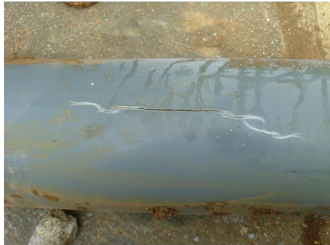
図4 疲労破壊による亀裂
